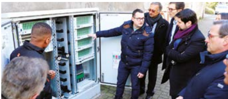
● Les armoires de raccordement de la fibre optique sont toutes installées.
