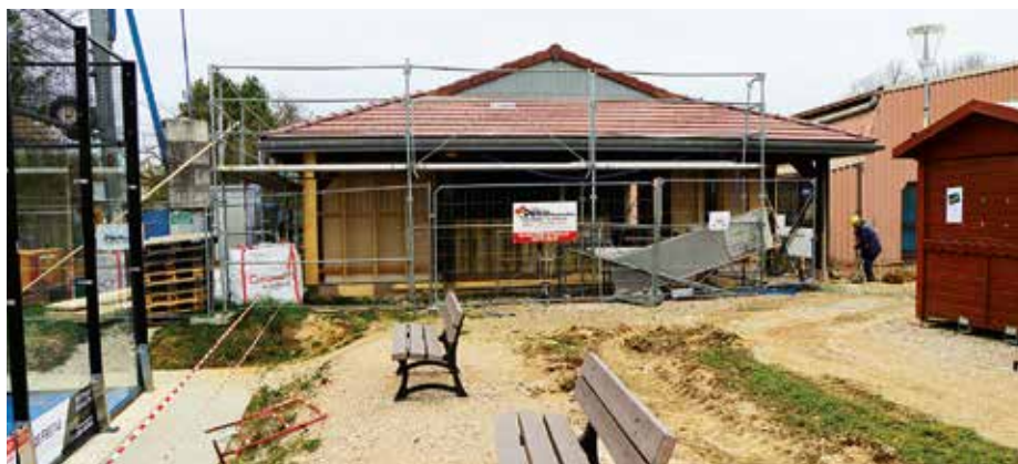
● Le chantier est en cours : la rénovation de la toiture vient d'être réalisée.
