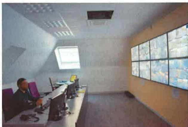
Centre de supervision de la ville de Dole
