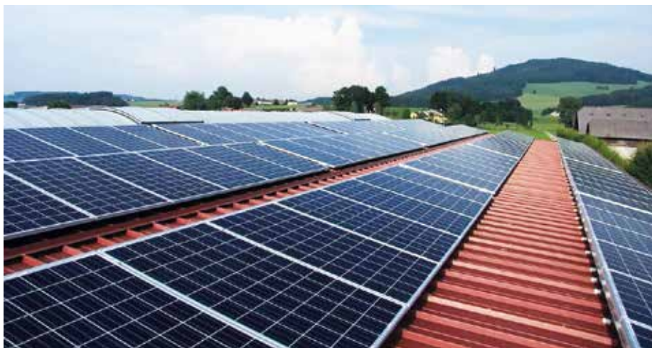
● Exemple de panneaux solaires sur une toiture.
